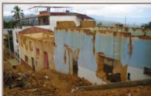
Fig. 5. Vivienda destruída en terremoto de Lamas (setiembre 2005).
